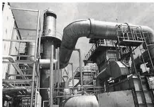
山形の工場に設置された排ガス燃焼装置
