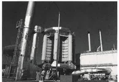
米国の工場に設置された有機溶剤回収装置
