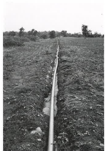
約1マイルに及ぶ配管設備。
